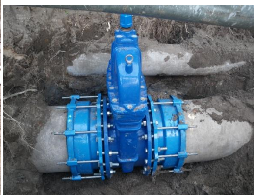
Détail de la vanne d'isolement du collecteur
