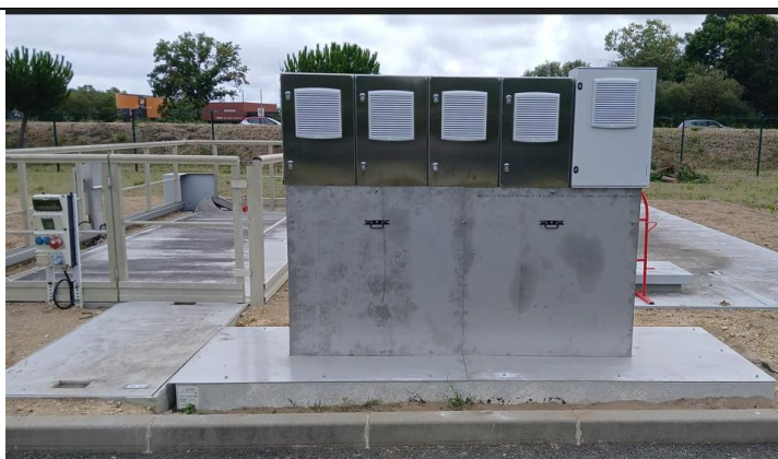
Coffrets en service
