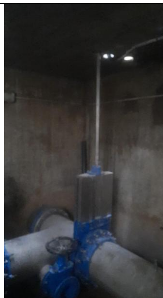
Vue d'une nouvelle vanne motorisée
