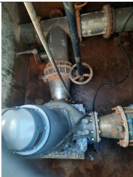
Vue des vannes existantes
