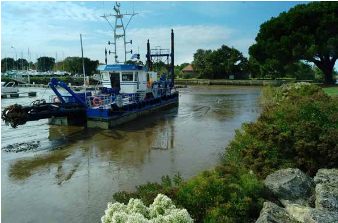
Dragon dans le port du Teich au cours de l'installation de chantier
