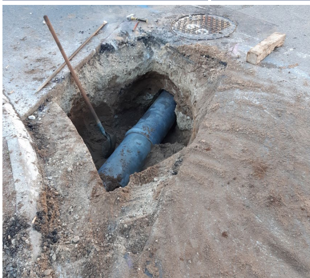
Reprise d'une canalisation affaissée Arcachon.
