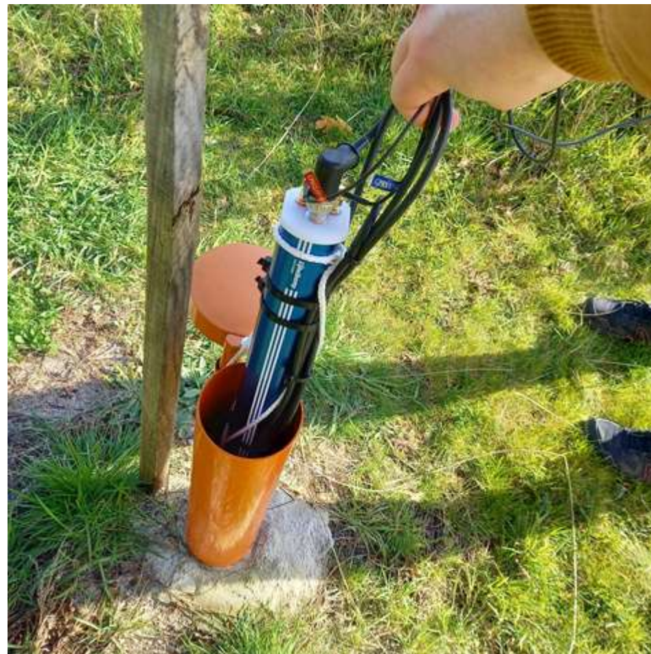
Sonde communicante installée sur le piézomètre aval
