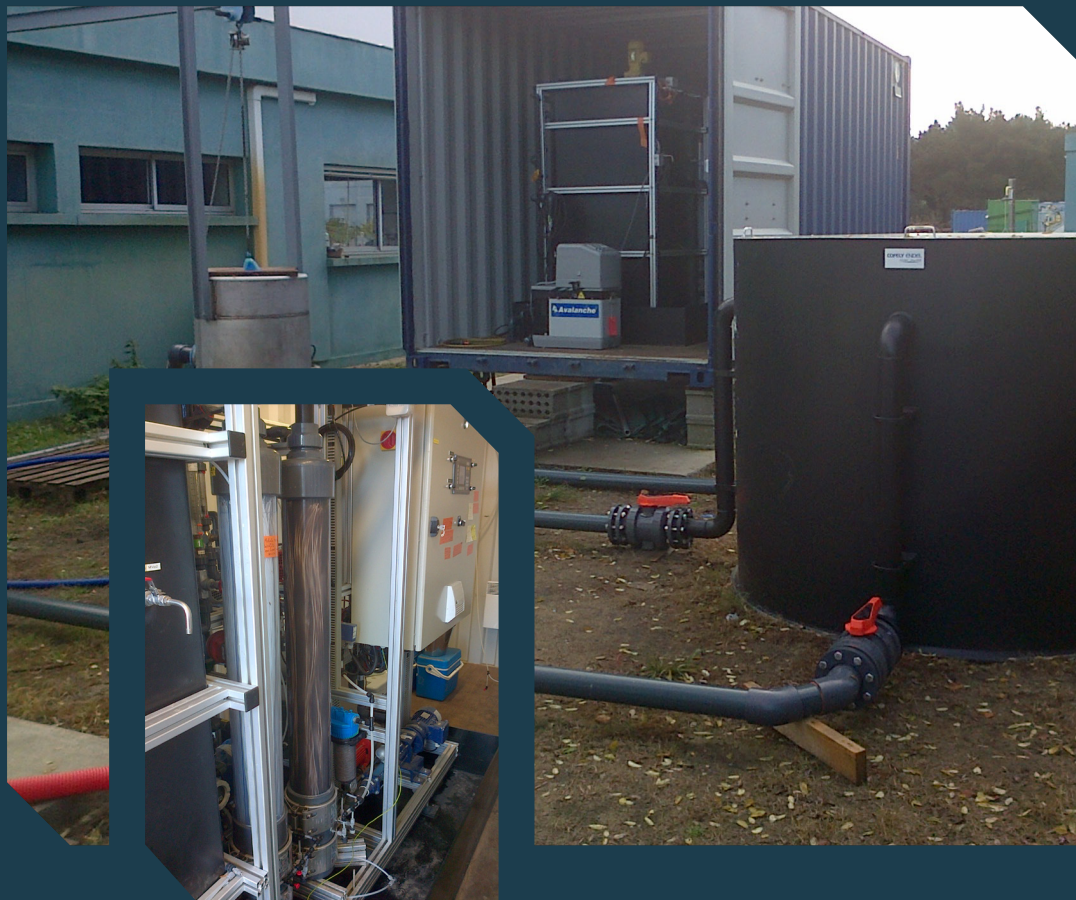
Figure 7. Pilote de bioréacteur à membrane sur site et détail des membranes de filtrations.
