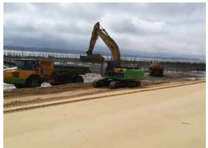
Pendant travaux, talus du Mimbeau
